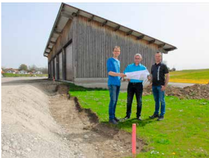
Der Lengenwanger Vereinstadel wird erweitert – zum Spatenstich kamen zusammen: (von links) Christoph Hitzelberger (Baugeschäft Hitzelberger), Bürgermeister Albert Schreyer jun., Tobias Fendt (Fendt Holzbau und Planung) – Foto: Gwendolin Sieber
